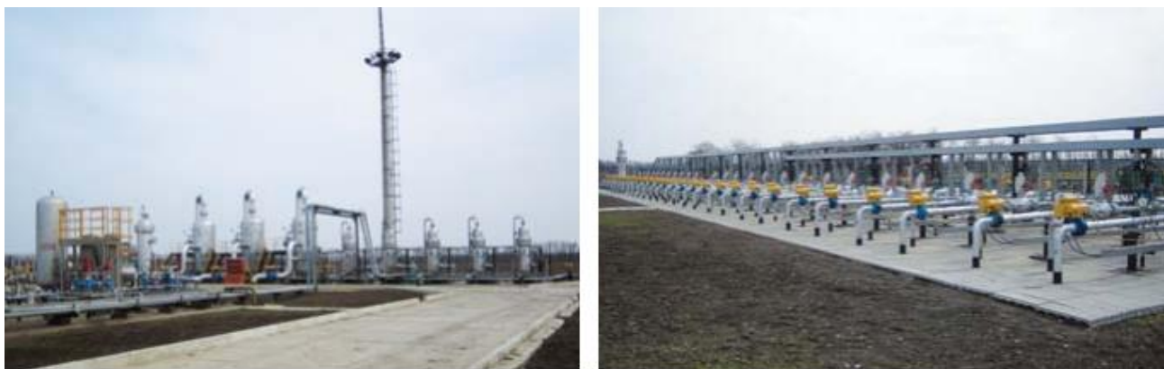
Рисунок 1.1 – Газосборный пункт, станции подземного хранения газа
